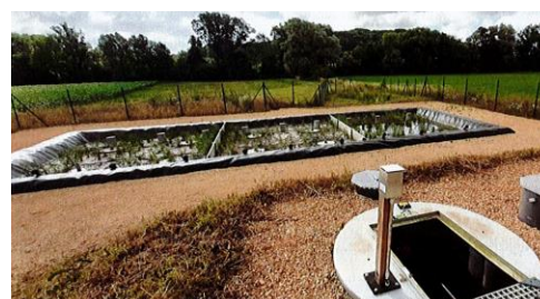
Figure 13 : Station de traitement de Mesnil sous les Côtes
